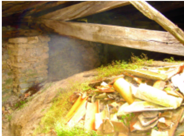
Foto 5 Trasdós de bóveda principal, con ruina parcial de cubiertas.
