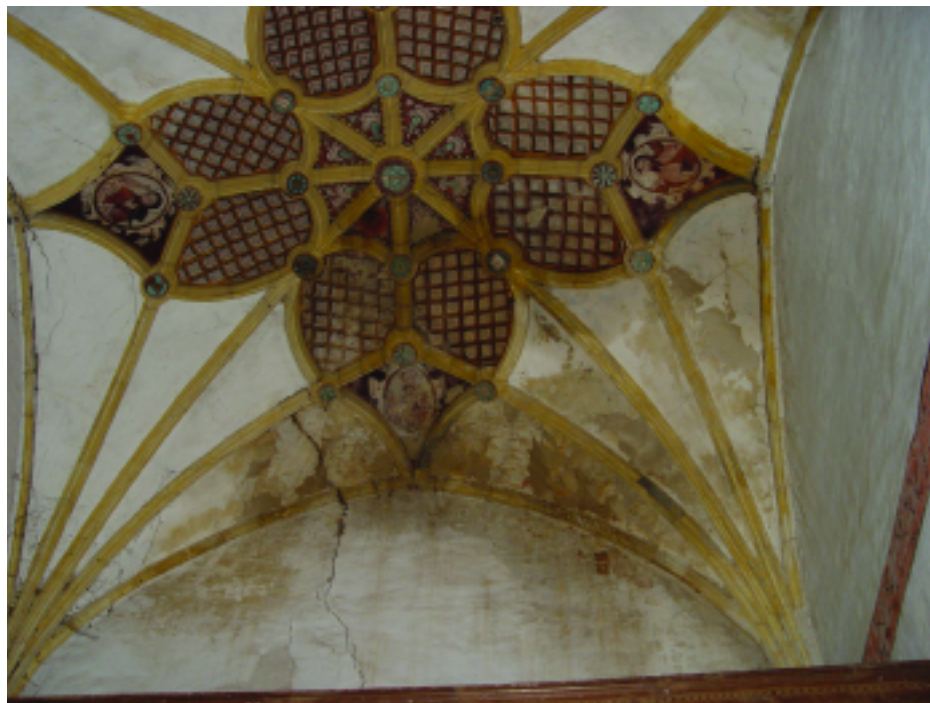
Foto 6 Bóveda pincelada del primer tramo occidental de la nave, con humedades y problemas estructurales, Petra S.Coop.
