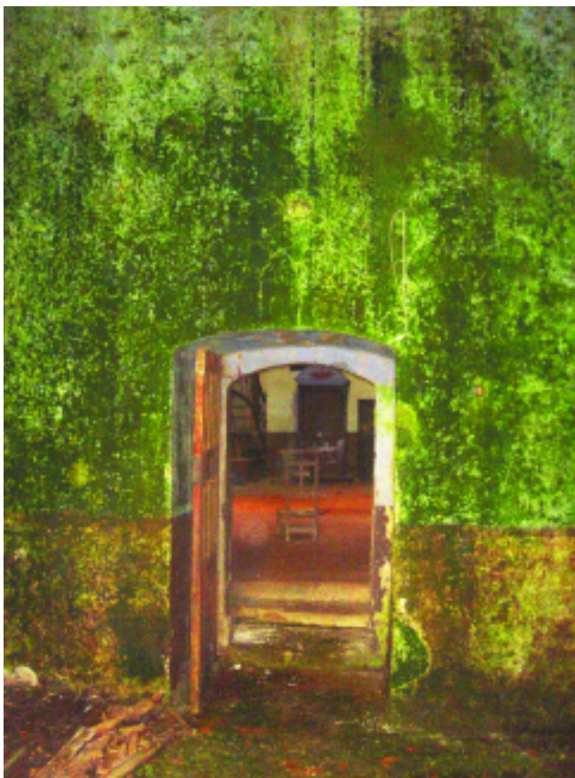
Foto 3 Muro interior de sacristía, con colonización vegetal.
